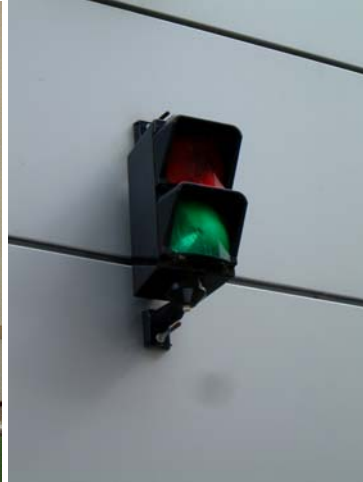
Semafor u vjezdu do výtahu
